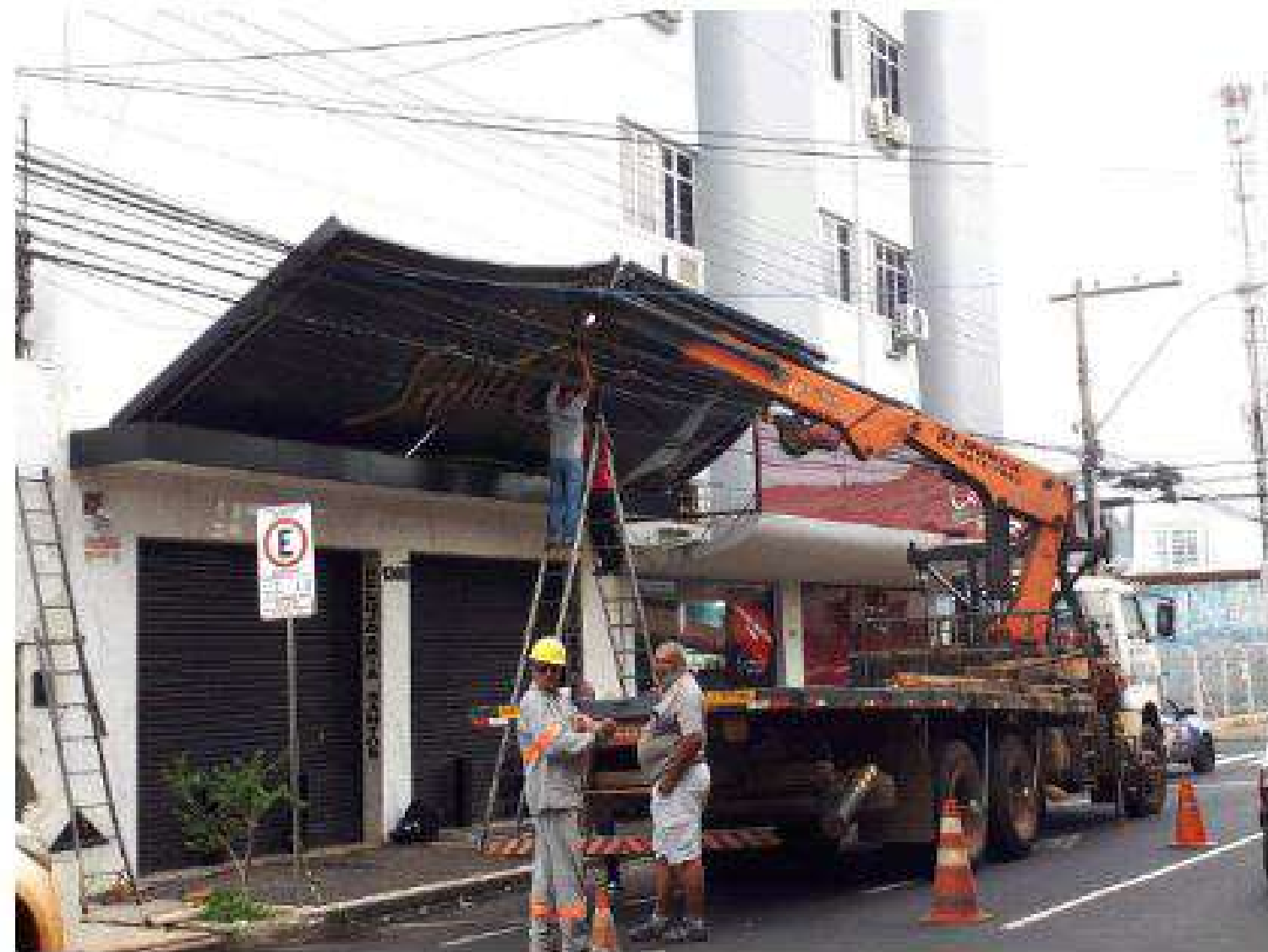
Letreiros de estabelecimentos comerciais foram arrancados com a força do vento no Centro (Foto: Diário de Uberlândia)
