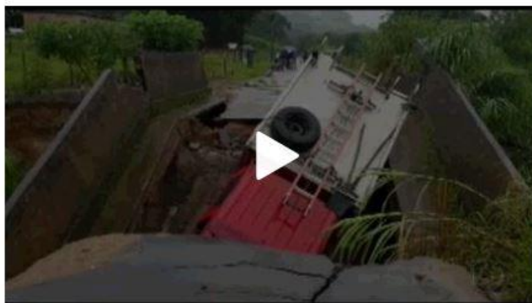
Chuva forte volta a provocar estragos e prejuízos em Minas Gerais
