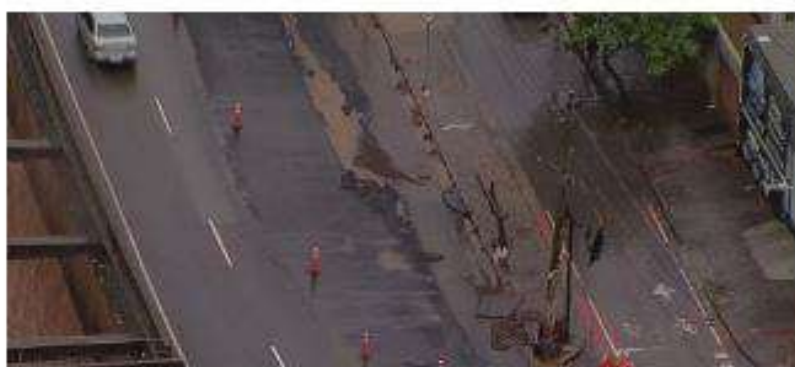
Parte do asfalto da Avenida Tereza Cristina foi arrastada pela enxurrada — Foto: Reprodução/TV Globo
