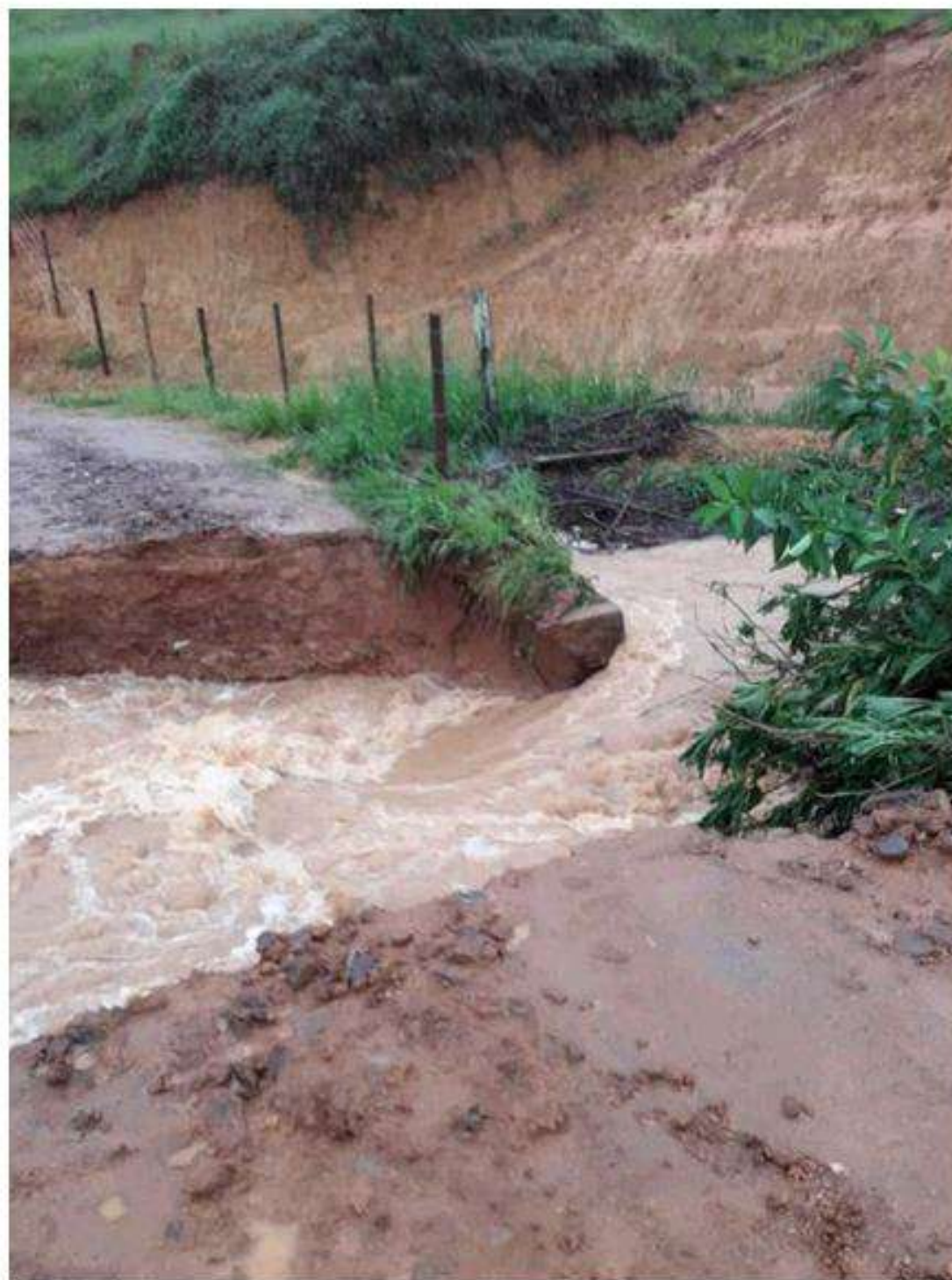
Ponte caiu após as chuvas em Tabuleiro (MG) — Foto: Corpo de Bombeiros/Divulgação
