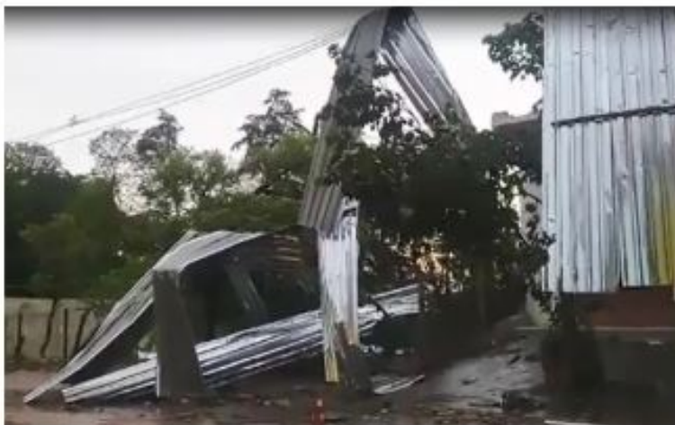
Telhado de lojas destruído no bairro Veneza, em Ribeirão das Neves — Foto: Jackson Lobra/TV Globo
