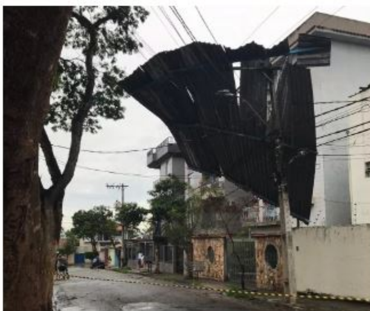
Telhado de igreja é lançado durante forte chuva com ventos em Belo Horizonte — Foto: Isabela Scalabrini/TV Globo
