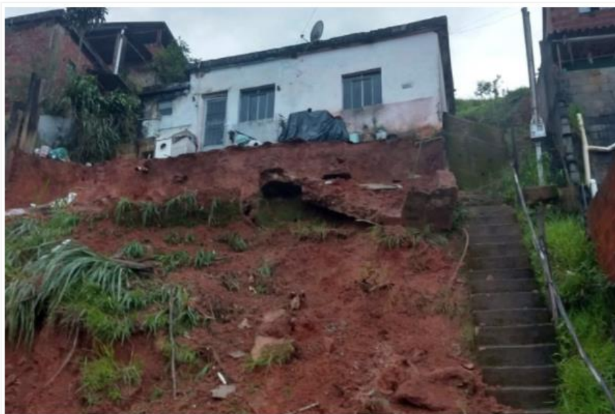
Escorregamento de talude na Vila Alpina foi um dos chamados atendidos durante à tarde (Foto: Defesa Civil)
