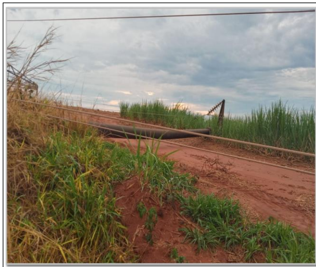
Figura 4: Registro de estrutura da LD Avatinguara – Campina Verde 2 138kV ao solo
