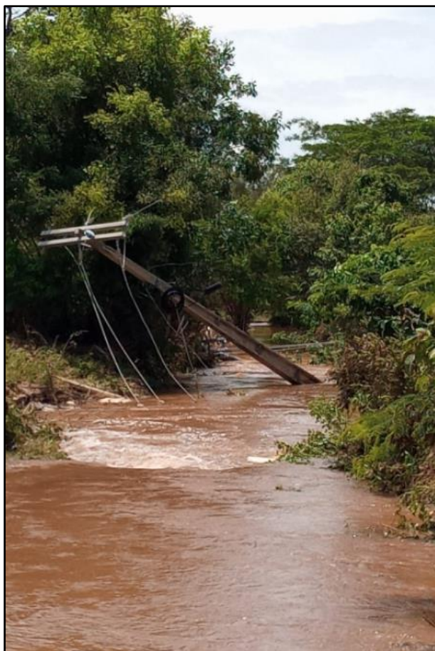
Figura 12: Dificuldade de acesso às redes danificadas em Porteirinha
