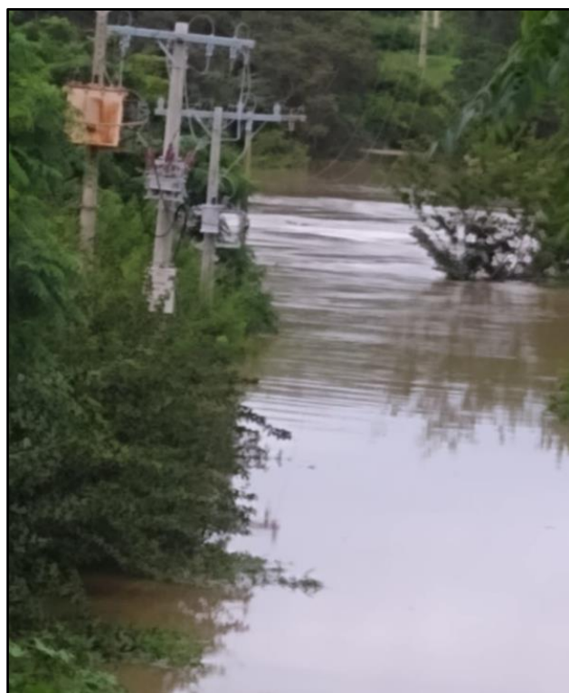
Figura 14: Nível elevado das águas próximo à rede próximo à UH Machado Mineiro
