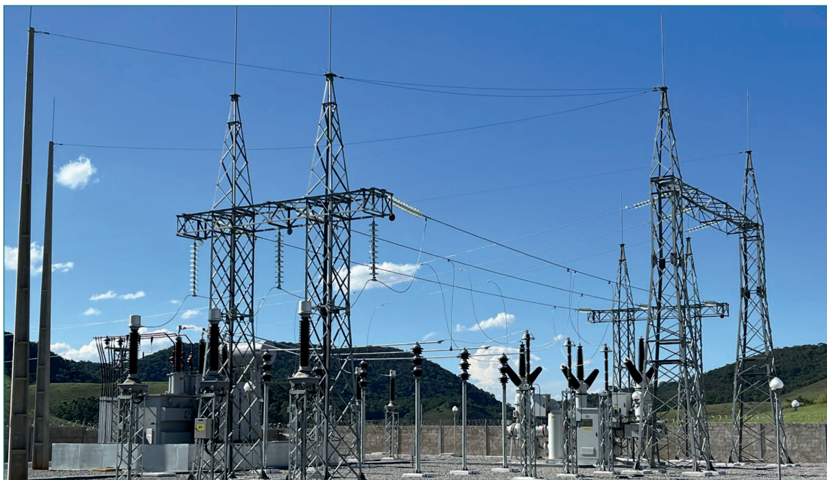
Subestações de energia garantem mais energia e qualidade na rede de todo o estado
